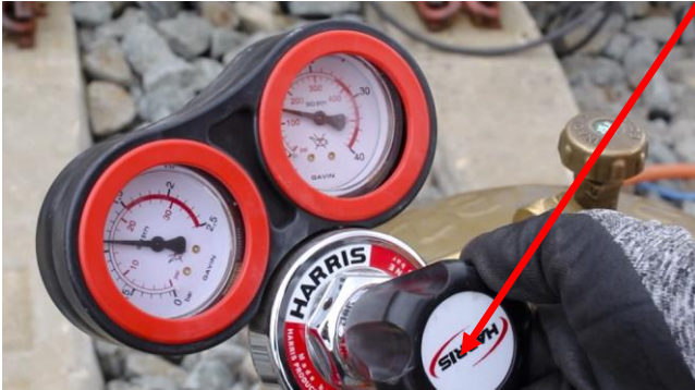
Ligne d'alimentation Propane
